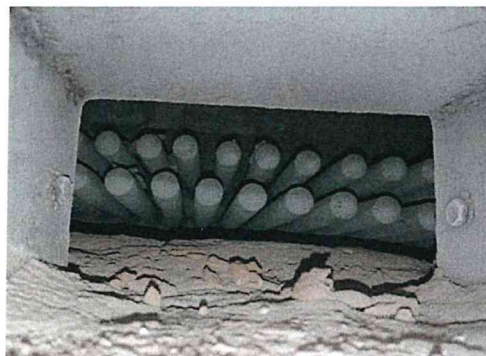
Rys. 13. Końcówki rurek Perkinsa w piecu RRK (piec wrzutowy 3-komorowy) [14]
