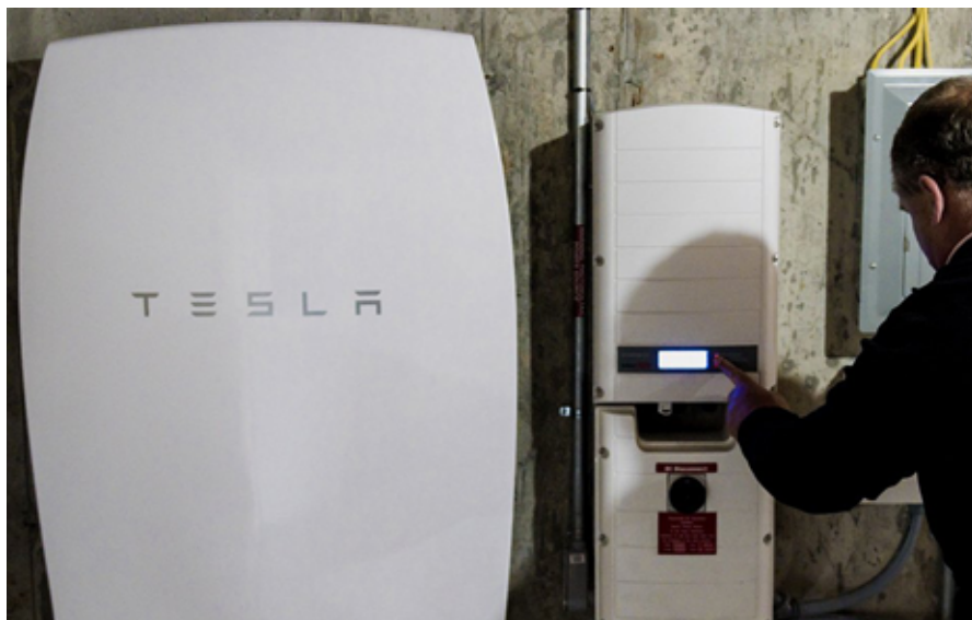
Rys. 13. Przykład domowego magazynu energii
