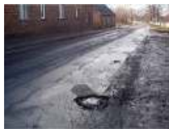
odnowa nawierzchni drogi wojewódzkiej nr 434 w m. Śródka – przed remontem
